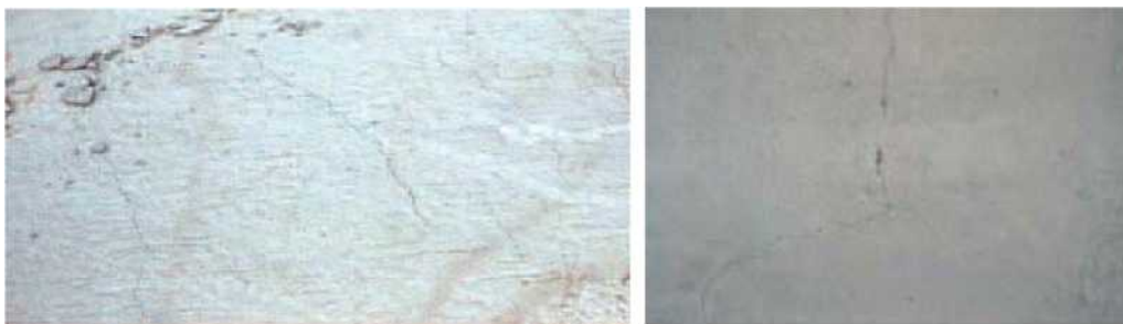
Εικόνα 1 - Ρηγματώση σκυροδέματος σε πλαστική κατάσταση
